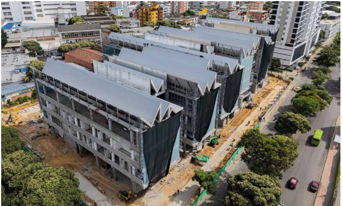
La obra inició su ejecución en octubre de 2022, lleva un 90% de avance a la fecha. Estas nuevas instalaciones permitirán a la UIS consolidar un complejo académico-científico al servicio de la salud pública en el nororiente colombiano.
